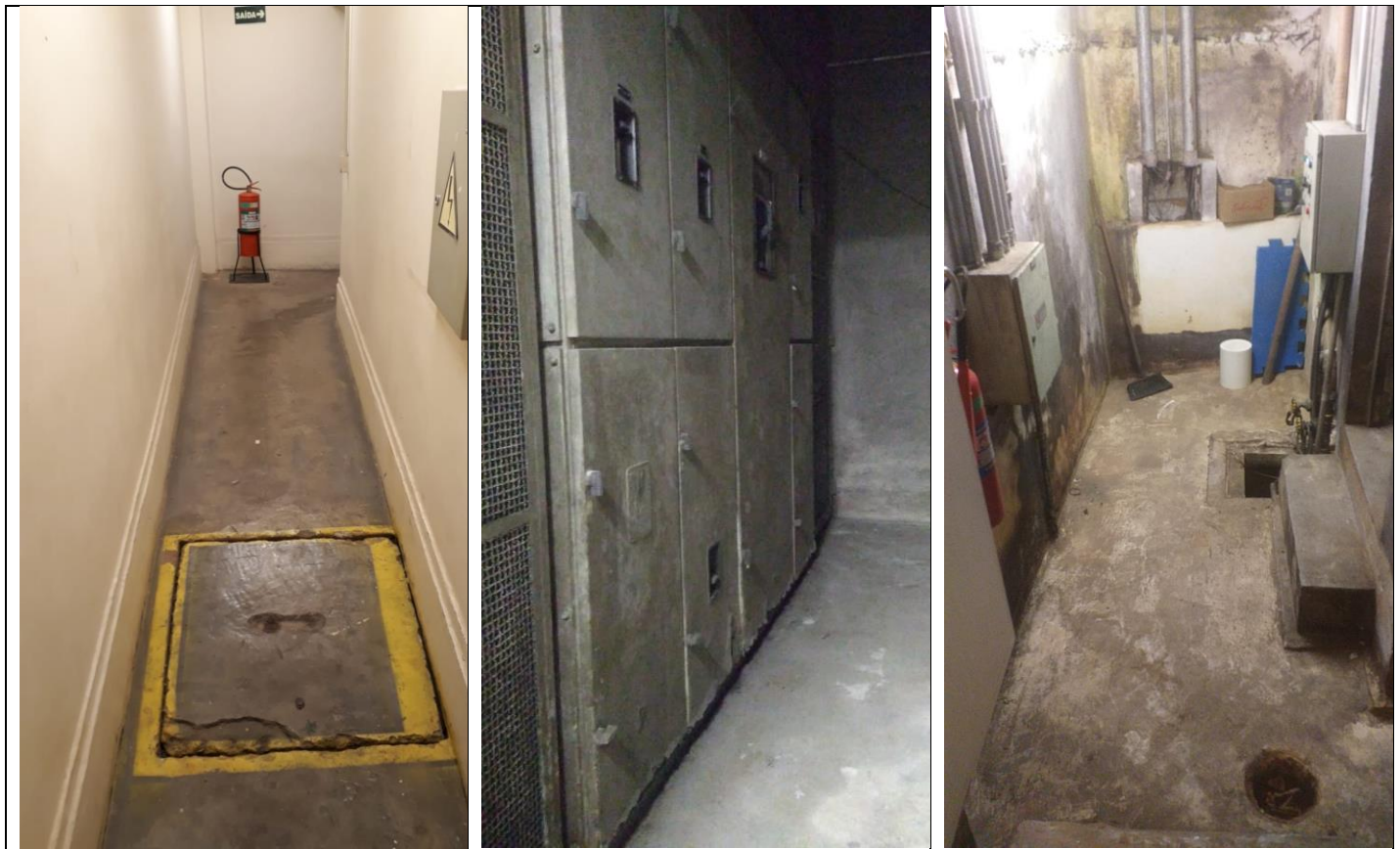
Poço artesiano, Cabine de barramento, Bombas e Quadro de energia
